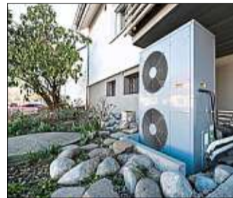
Ab 2024 neu installierte Heizungen müssen zu 65 Prozent mit erneuerbaren Energien betrieben werden.
